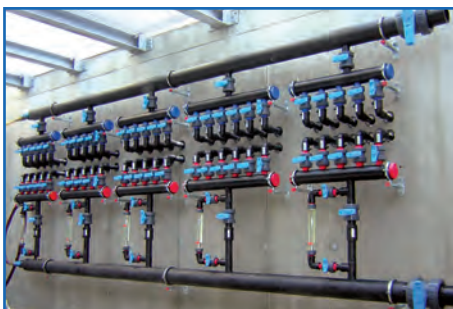
Großanlage für 26 Erdwärmesonden-Verteiler im Lichtschacht
